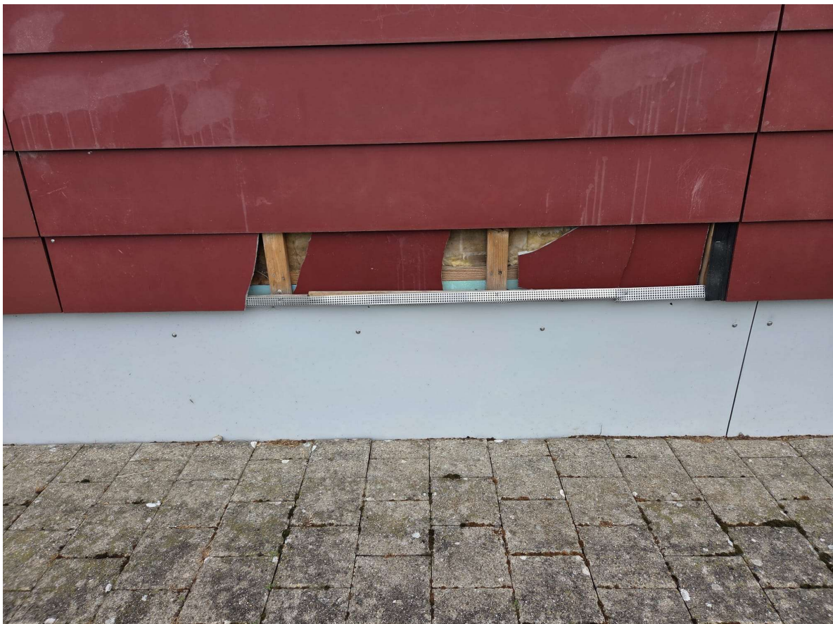
Beschädigte Fassade Heuberghalle
